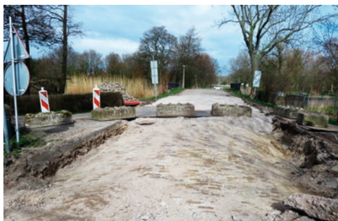
Tijdens het groot onderhoud aan de Osdorperweg wordt korte tijd het oude wegprofiel uit de jaren zeventig weer even zichtbaar.
