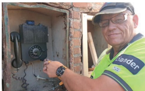
Hoofdmonteur Rob Teffer van Liander plaatst de oude telefoon terug in de GEB-kast aan de Sloterweg.
