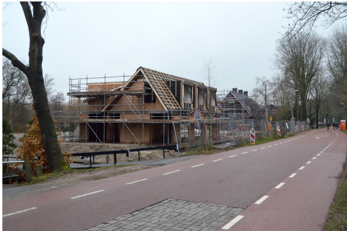
Januari 2020 en december 2022 aan de Sloterweg 711. Toen: de arbeidershuisjes kort voor de sloop, nu: nieuwe woningen in aanbouw op dezelfde locatie. Foto's: Erik Swierstra.
