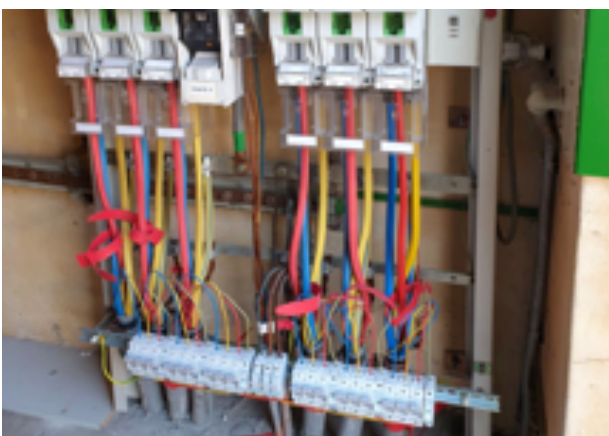
De stroomkabels in de 'bovennet-ruimte' van GEB-Wijkstation T.307 aan de Osdorperweg. Van hieruit gaan de kabels ondergronds naar 133 huishoudens en bedrijven op Sloten. Foto: Alliander.
