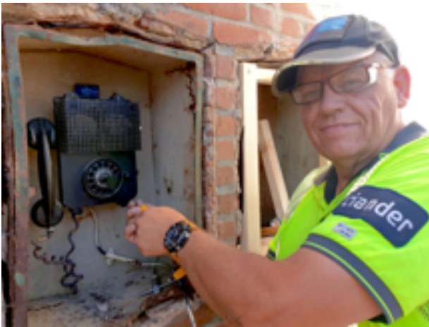
Hoofdmonteur en leermeester Rob Teffer van Liander plaatst de oude telefoon in de linker GEB-kast aan de Sloterweg.
