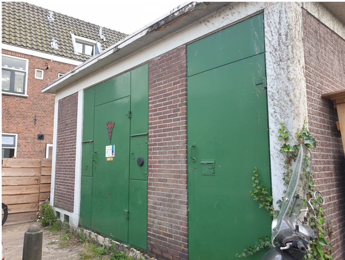
Wijkstation T.307 aan de Osdorperweg op Sloten is sinds 30 april 1932 tot op de dag van vandaag in gebruik. Foto: Guido Frankfurter.
